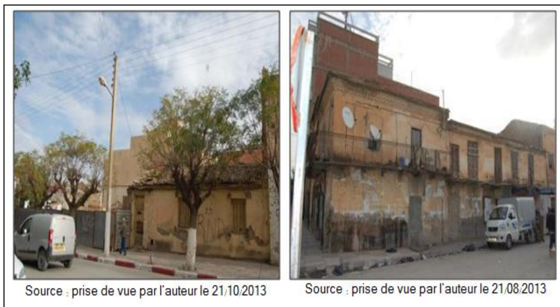
Photo VI-2: État de délabrement des constructions coloniales, sur la route de Biskra en plein centre-ville, laissées sans aucune intervention urbaine
